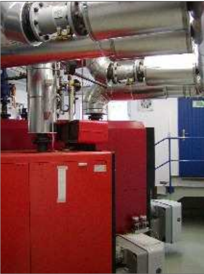
...und diese Spitzenkesselanlage zur Absicherung.... Martin Angelstein
