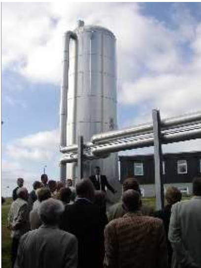
Ein "Pufferspeicher" mit 13 Kubikmeter Inhalt .....
